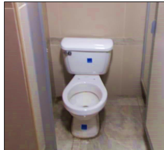
Imagen 02: Servicios/ inodoro Fuente: Propia
